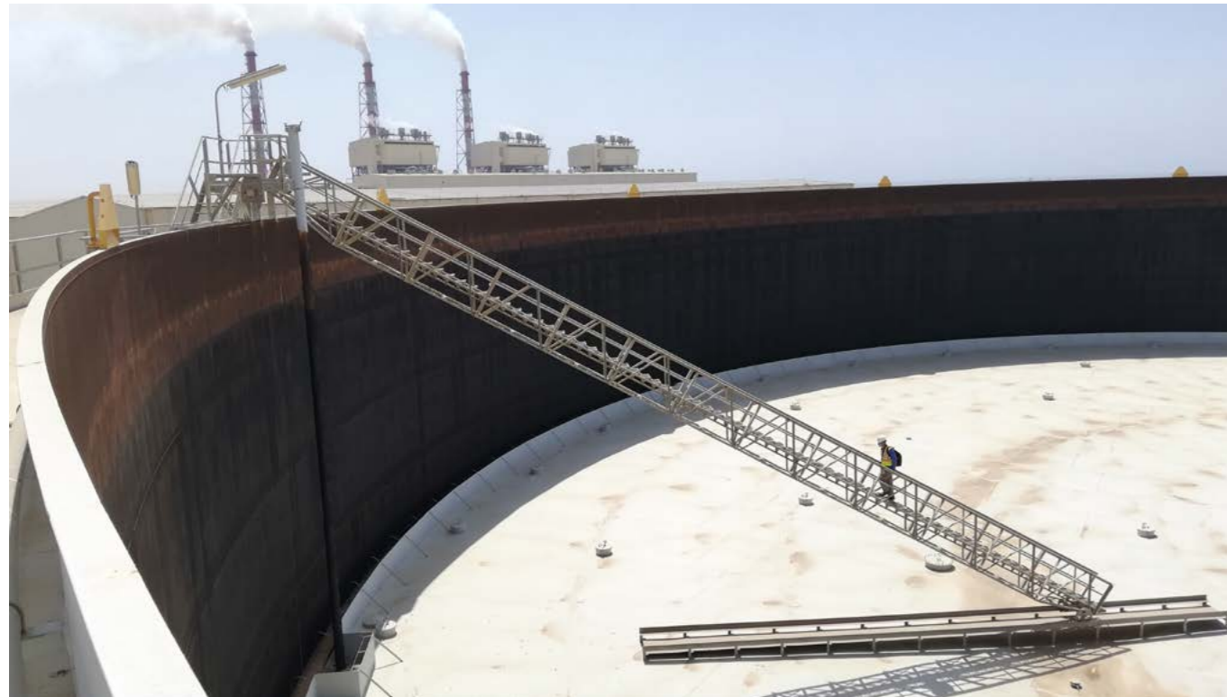
Εργασίες Επιθεώρησης σε υπέργειες δεξαμενές υγρών καυσίμων στην Σαουδική Αραβία. Inspection works on crude oil tanks in Saudi Arabia.
