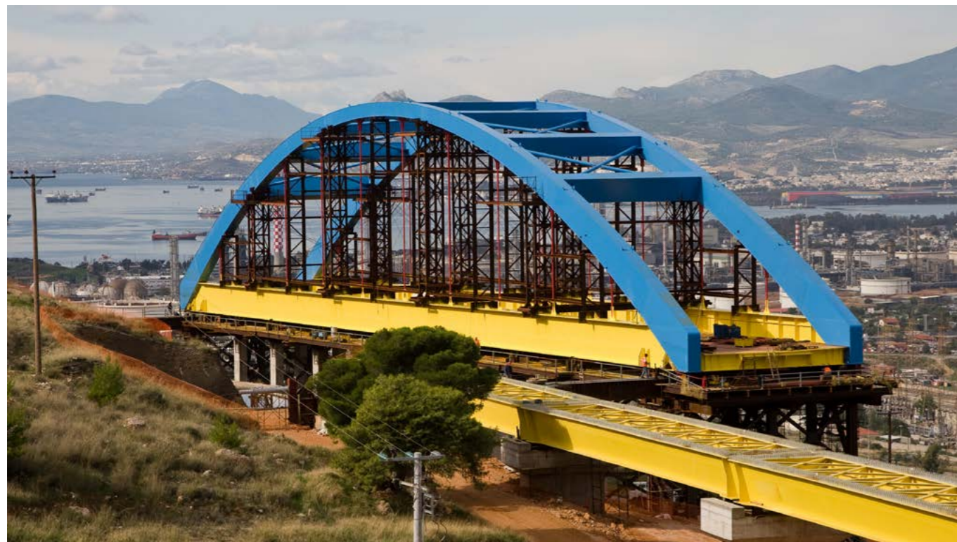
Κατασκευή σιδηροδρομικής μεταλλικής τοξωτής γέφυρας στο Ικόνιο Αττικής. Construction of a railway metal arched bridge in Ikonio, Greece.
