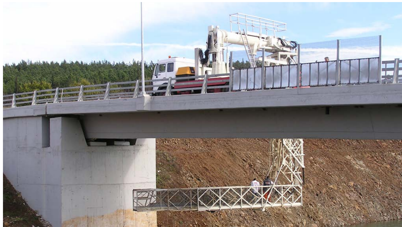
Επιθεώρηση γεφυρών στη Βόρεια Ελλάδα, με την χρήση "by bridge". Bridges Inspection in Northern Greece, with the use of "by bridge".
